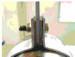
②上部に隙間がある
